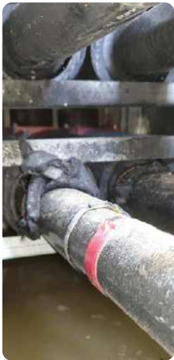
Figuur 13: Water in het keldercompartiment (bron: Enexis).
